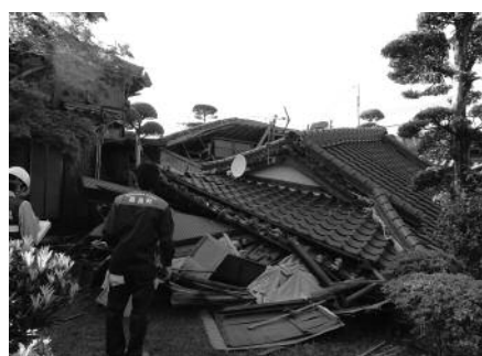
倒壊した家屋
