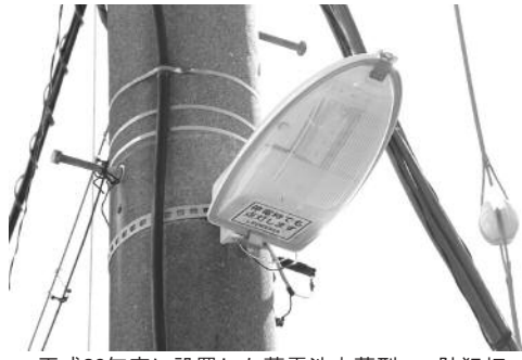
平成26年度に設置した蓄電池内蔵型LED防犯灯
