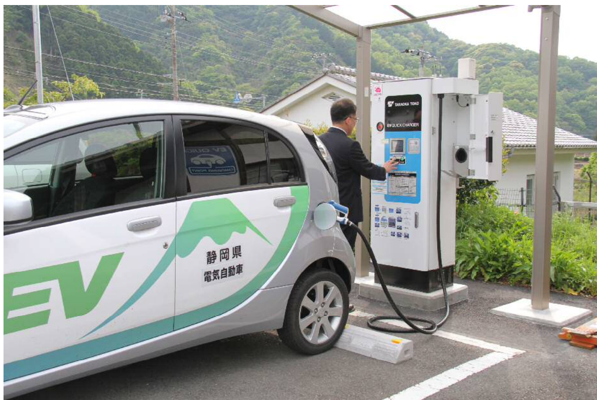
▲道の駅 花の三聖苑伊豆松崎 急速充電器を新設
