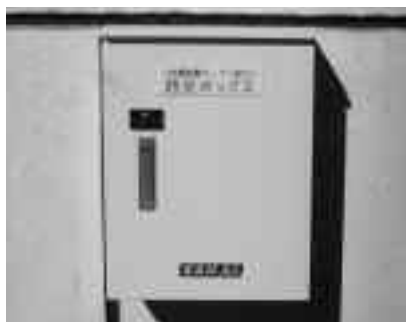
設置した防災ボックス
