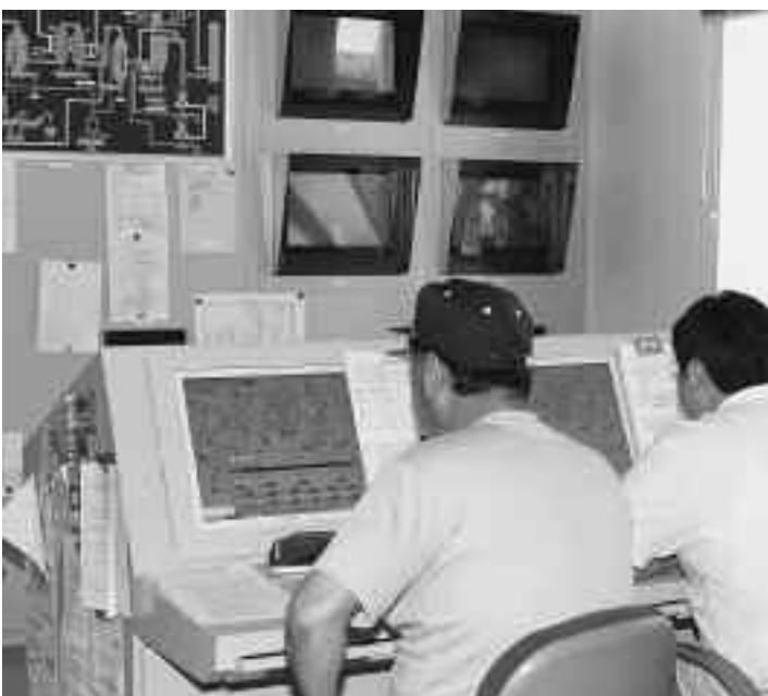
クリーンピア松崎中央制御室
