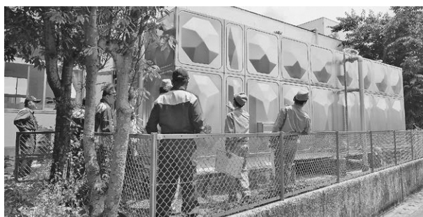
更新された受水槽施設
