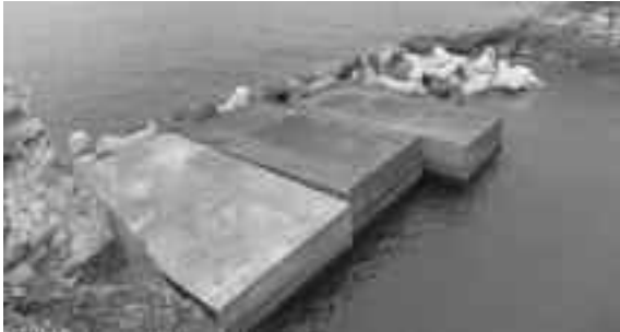
台風18号で被災した雲見防波堤
