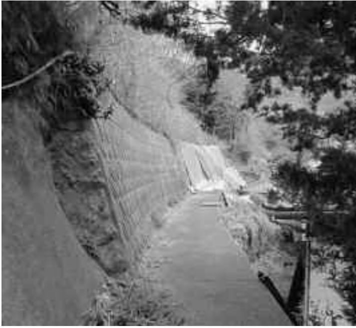
災害復旧工事の早期着手を（町道星山線）
