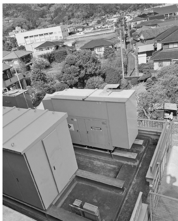
非常時の生命線となる役場自家発電装置
