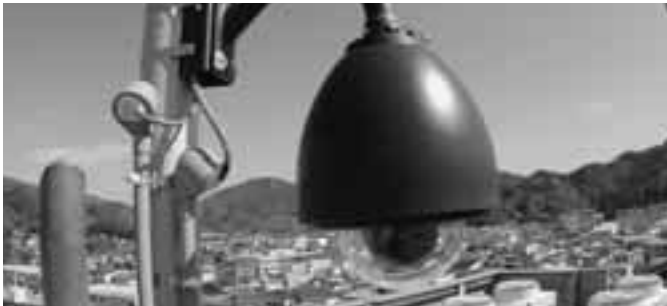
津波監視カメラ(伊豆まつざき荘屋上)
