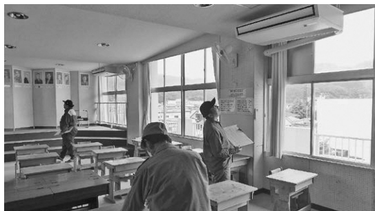
音楽室に設置された空調設備
