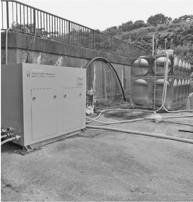
新たに設置された浄水施設（雲見）
