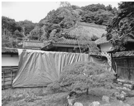
補修が必要な塀 (旧依田邸)
