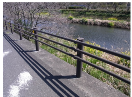
透過性の高いガードパイプ
