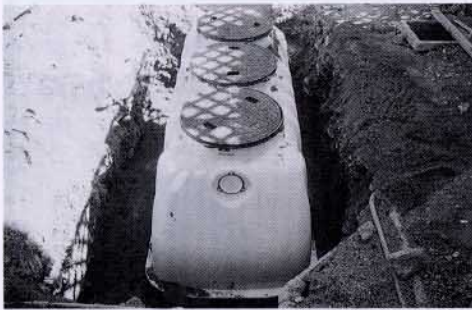
▲合併処理浄化槽
